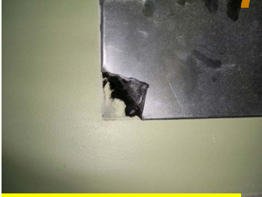
Ablösung im Bereich von Ecken und Kanten
